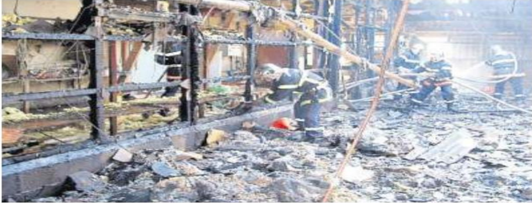
Les pompiers ont fait « la part du feu » à hauteur du local technique, ce qui a permis de protéger la seconde partie du bâtiment de 1 620 m 2 .
